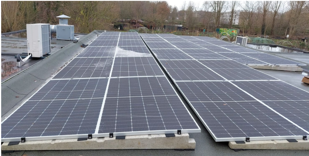
Foto: Zonnepanelen op het dak van stichting Schets
